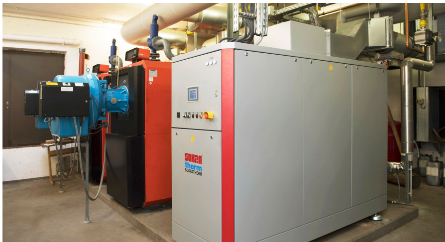
▲ Das neue BHKW wurde im zweiten Bauabschnitt an das bisherige Heizsystem angebunden und kann nun direkt über den Webeditor gesteuert und gewartet werden.
