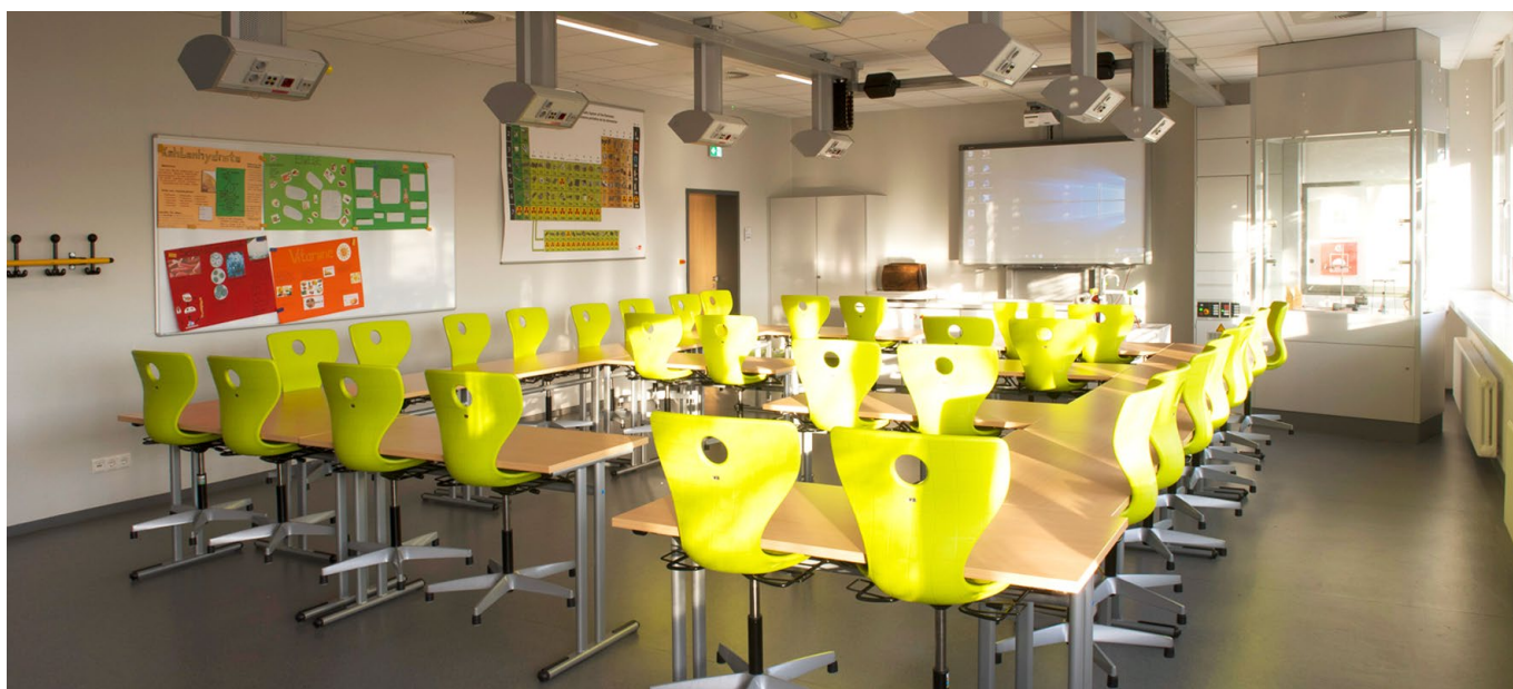
▲ La reconversion prévoyait également l'aménagement de nouvelles salles de chimie, dont les hottes ont aussi été reliées à l'installation de ventilation.
