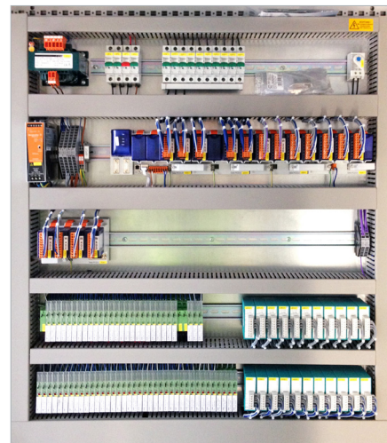
▲ Chaque nouveau bâtiment du lycée abrite des armoires rassemblant les appareils d'automatisation, ce qui permet une maintenance centralisée sans interrompre le fonctionnement de l'école. Photo © Bureau d'études Christian Förster GmbH
