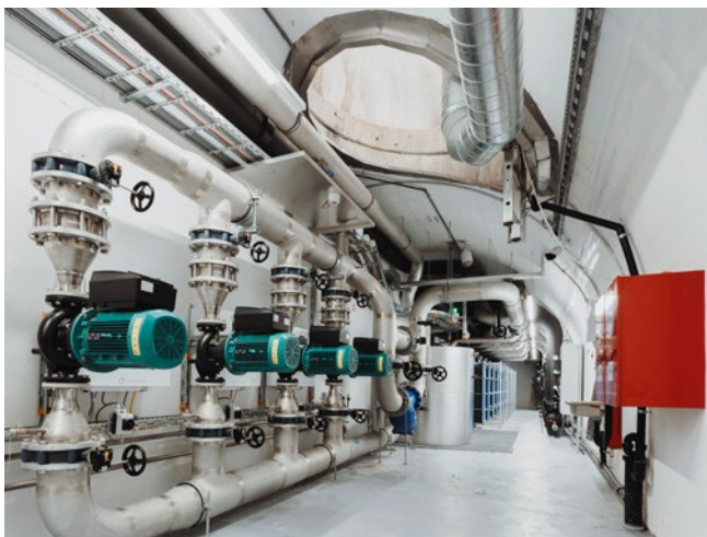
Pompes fonctionnant en alternance pour un refroidissement durable avec l'eau du lac
